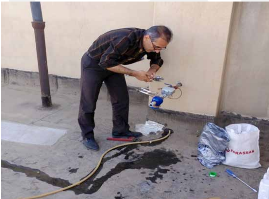
نصب کنتورهای هوشمند و مکانیکی برای اندازه گیری خطا
